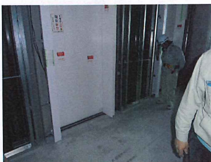
エレベーター前の開口が表示、転落防止処置共に無し
